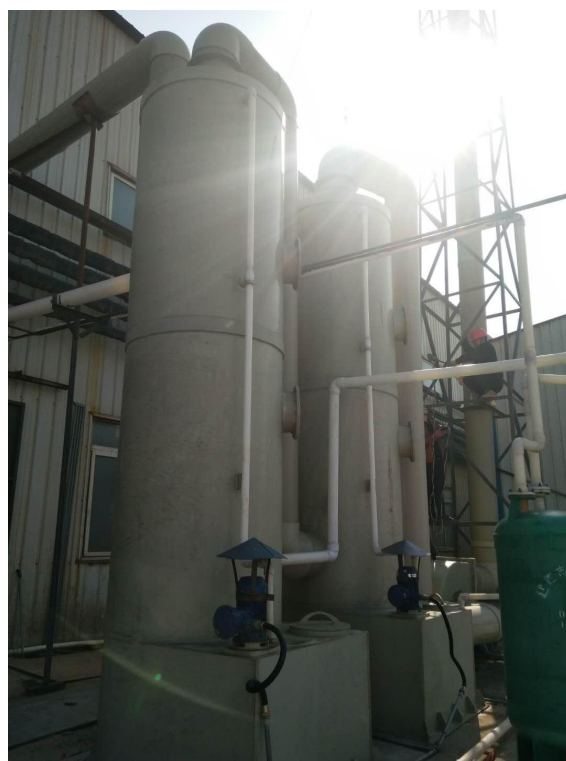
图4-2 有机硅树脂生产线尾气吸收装置
