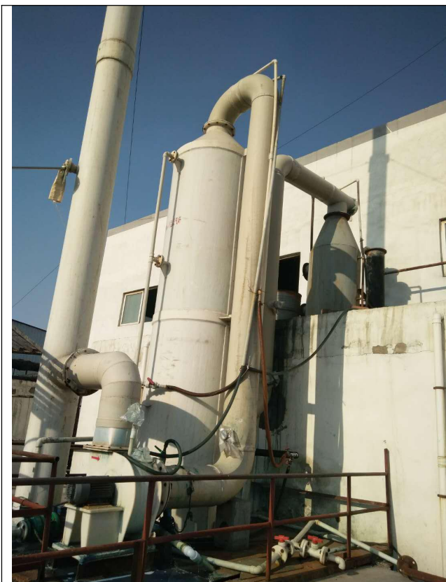
图 4-1 铜酞菁缩合工序尾气吸收塔
