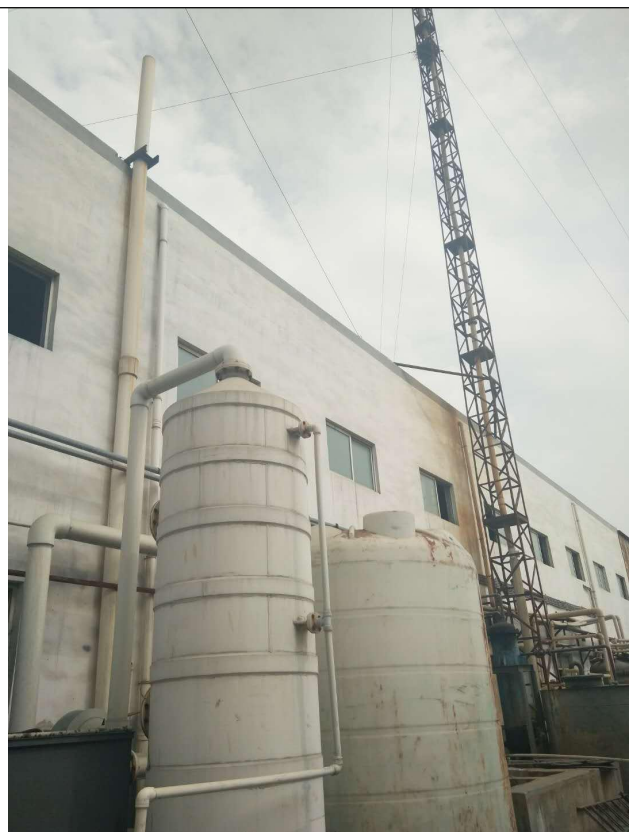
图 4-2 铜酞菁精制工序尾气吸收塔
